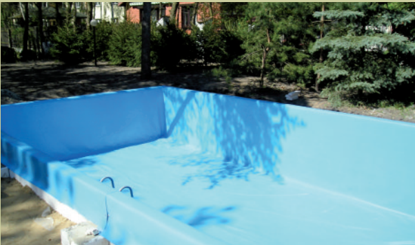
Basen Włocławek FolGam B 200 m 2 (2006) / Włocławek, Swimming pool FolGam B 2000 m 2 (2006) / Бассейн Влоцлавек FolGam B 200 м 2 (2006)
