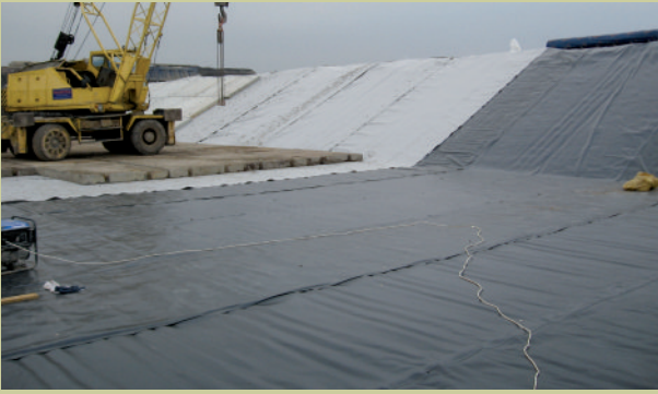
Zbiorniki na wody gruntowe w Kopalni Bogatynia 70 000 m 2 (2007/2008) / Ground water basin in Bogatynia brown coal mine 70 000 m 2 (2007/2008) / Бассейны грунтовых вод на шахте Богатыня 70 000 м 2 (2007/2008)
