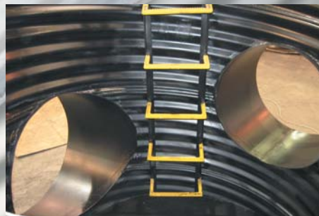
wyposażenie studni i pompowni
